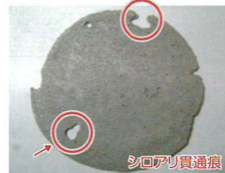
一般的なモルタル シロアリ貫通痕
