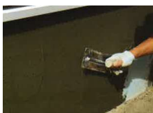
リフェイスBI(全面補修) ピンホールのない平滑な下地作成
